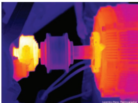
1. Identificazione di un potenziale problema con una fotocamera a infrarossi Fluke.
